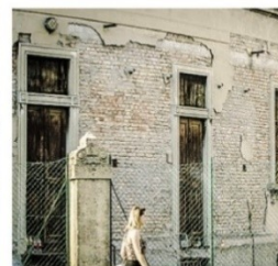
Il degrado dello stabile
